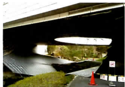
落下した外側の鉄板
