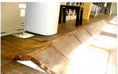
漏水で木タイルが浮いた床
